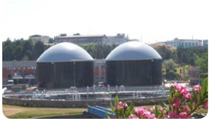
Digestori per biogas - Turchia
