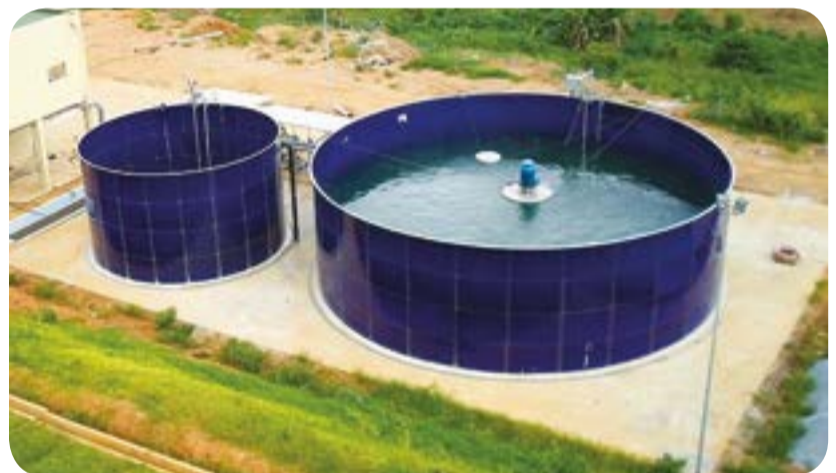
Serbatoio acque reflue - Costa d'Avorio
